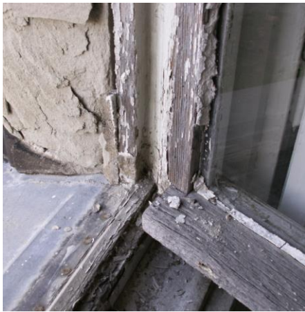
Abbildung 2: Völlig abgewittertes Kastenfenster, Dichtheit nicht mehr gegeben, Kitt ausgetrocknet und brüchig oder nicht mehr vorhanden (Bildquelle: Dirk Sommer, Berlin)
