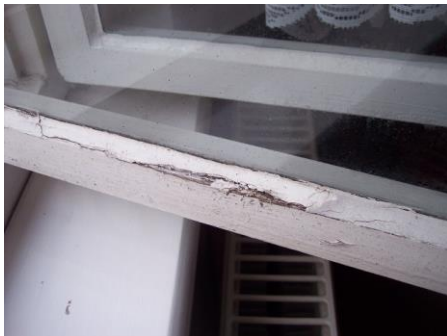
Abbildung 9: Risse und Abplatzungen in der Beschichtung des äußeren Flügelrahmenunterstücks an einem Kastenfenster (Bildquelle: Eike Gehrts, Linden)
