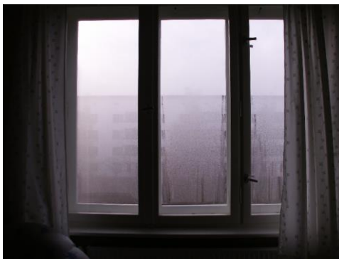
Abbildung 16: Erhebliche Tauwasserbildung auf der Innenseite der Außenscheiben eines Kastenfensters (Bildquelle: Dirk Sommer, Berlin)
